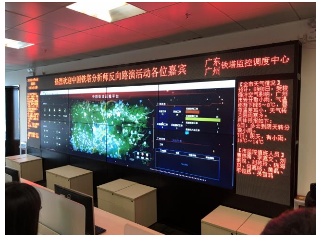
图6：中国铁塔控制室
