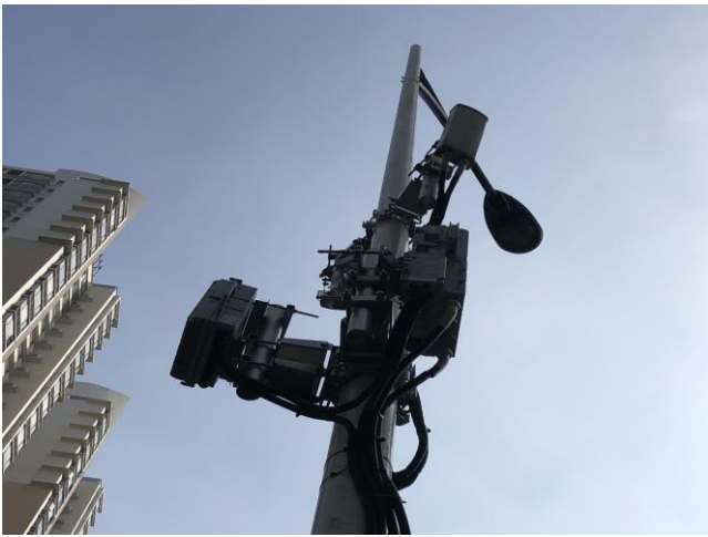
图3：路灯杆上的微站
