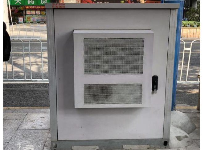
图4：集成电力设备
