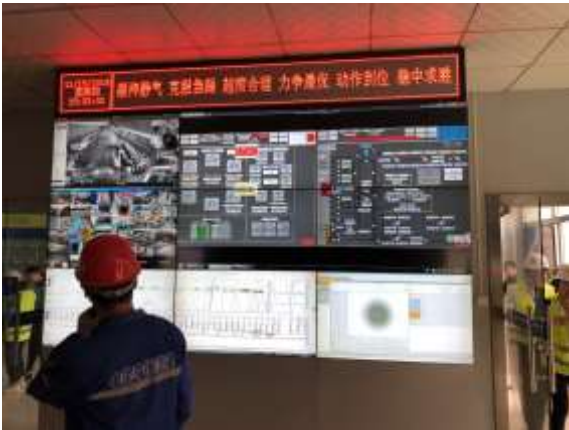
图3: 狮子洋隧道电子监控
