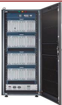
图 6：中心交换设备
