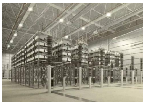
图 25：柔性直流输电的核心部件——换流阀塔
