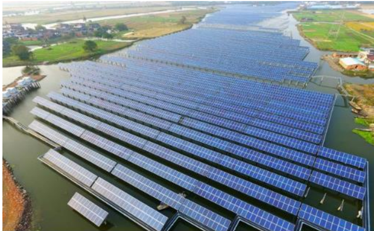
图 27: 已并网“渔光一体”示范项目
