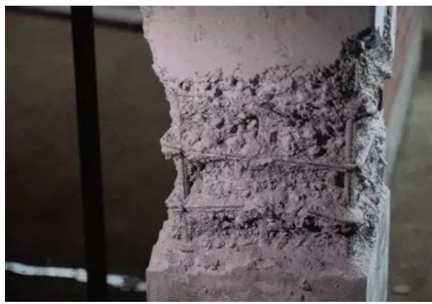
图 74：豆腐渣楼盘使用的劣质混凝土
