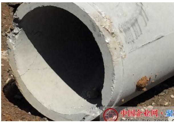
图 73：市政管网工程中使用的地方性劣质管材
