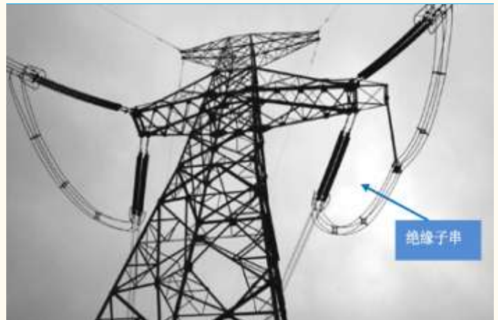
图表 2：三峡电站±500kV 直流架空线绝缘子
