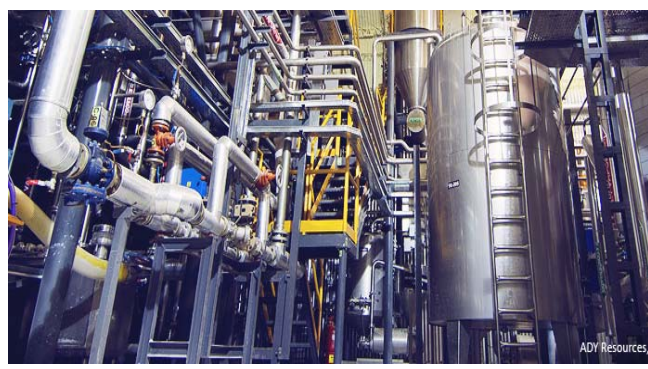
图 4: ADY Resources 在 Rincon 盐湖 1500 吨级展示厂房的内部构造
